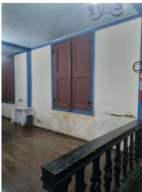
Imagem 57 - Paredes danificadas por infiltrações
