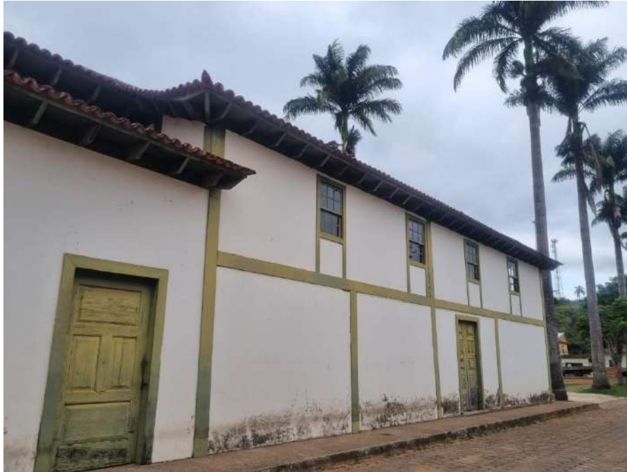
Imagem 61 - Fachada lateral e danos
