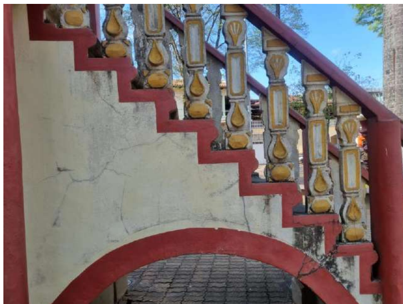
Imagem 40 - Degradação da estrutura e da pintura
