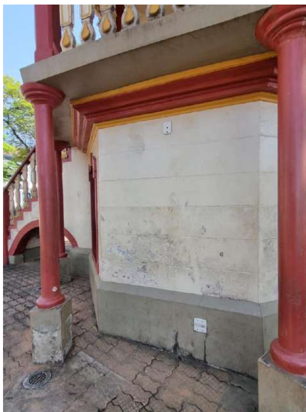
Imagem 39 - Degradação da pintura
