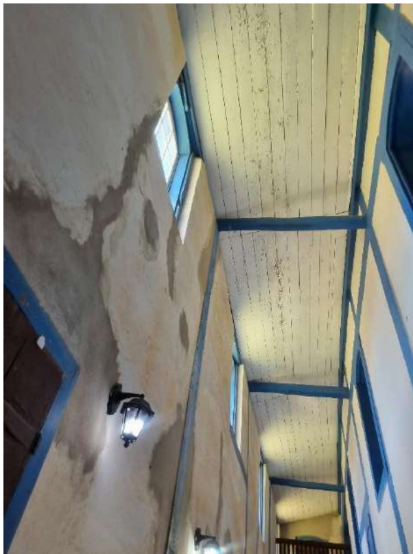
Imagem 27 - Paredes e forro danificados
